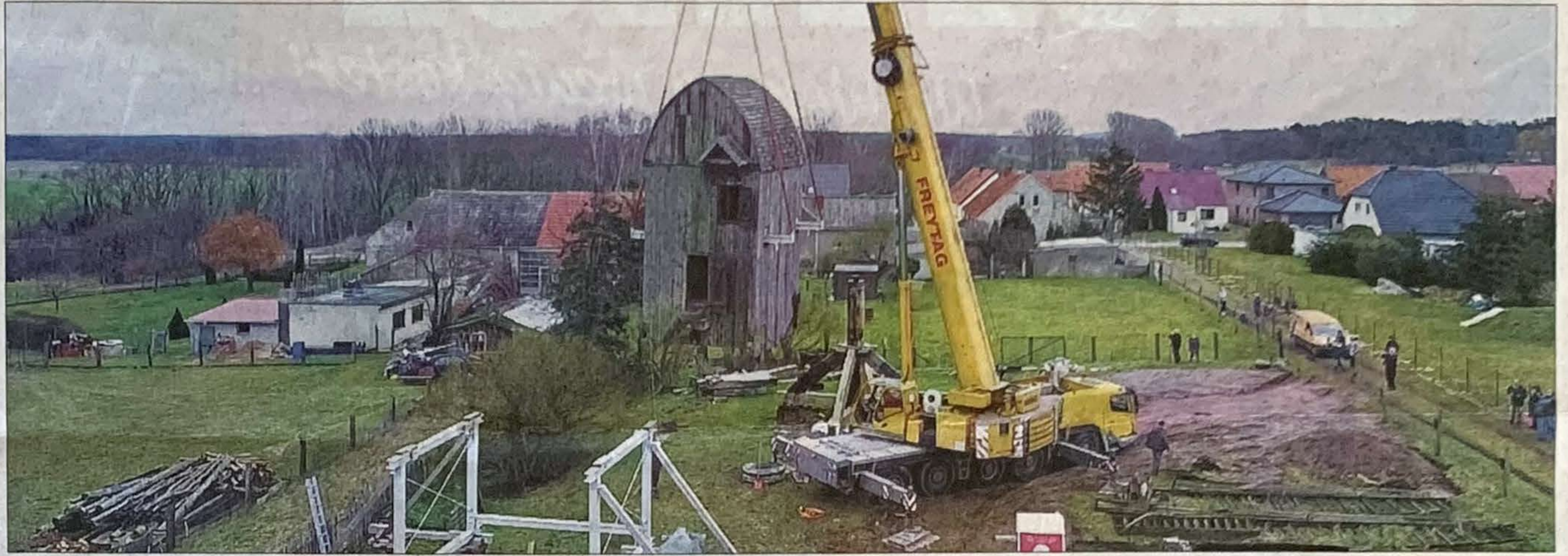
Die alte etwa 20 Tonnen schwere Holzkonstruktion schwebt am Kranhaken der Firma Freytag. Die gesamte Windmühle mit Flügeln und Inneneinrichtung wird später – nach der Schätzung des Zimmermannes Ulrich Blümner – etwa 35 Tonnen wiegen.
